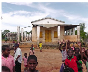
Zyklonschäden an einem Schulgebäude
